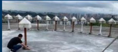
某机场空管站
