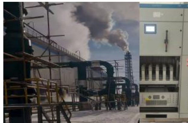
中海油鹤岗自备电厂 SVG
