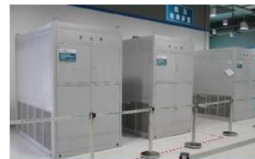
500KW孤岛系统测试平台
