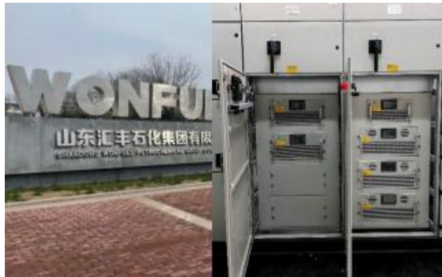
山东汇丰石化集团有限公司 APF&SVG
