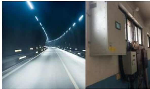
杭州绕城高速公路隧道 APF
