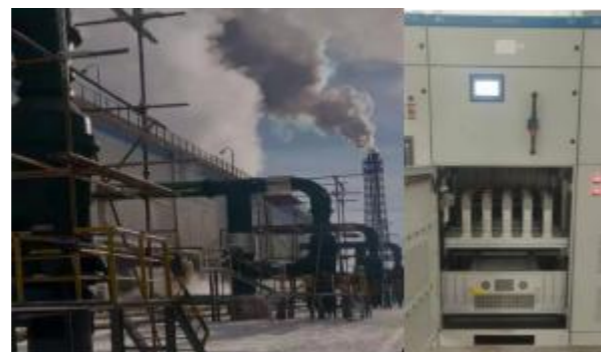
中海油鹤岗自备电厂 SVG
