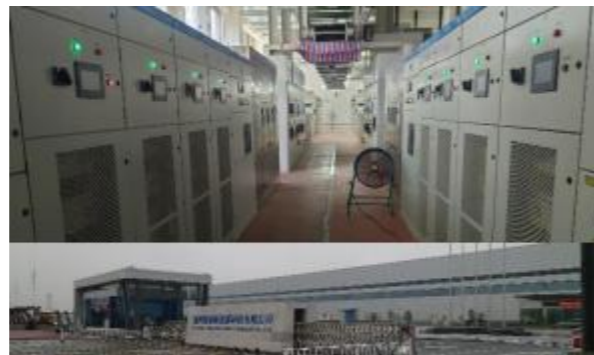
■ 滁州捷泰新能源科技有限公司 APF&SVG
