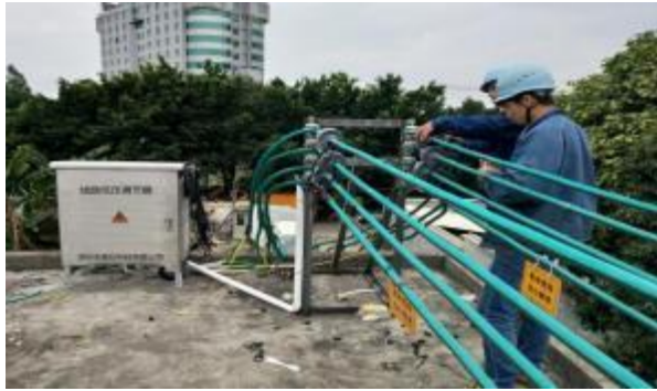
南方电网 LVR
