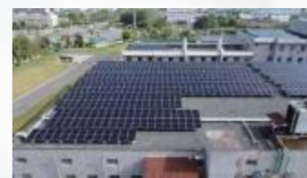
湖南春光九汇中药 厂房屋顶光伏
