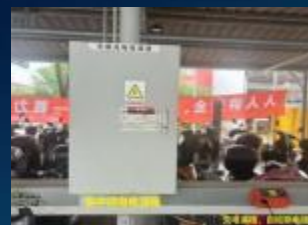
住宅小区充电棚
