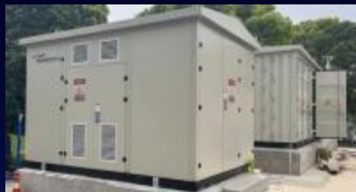
低压配电柜 (总线路侧)
