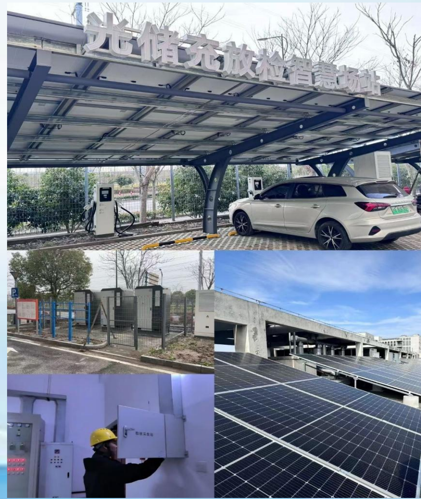
光储充一体智慧场站
