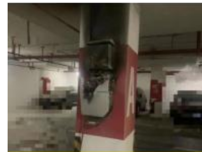
配电系统故障
