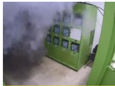
单车换电充电柜
