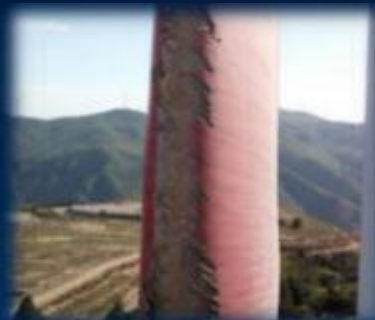
前缘腐蚀 排水孔堵塞
