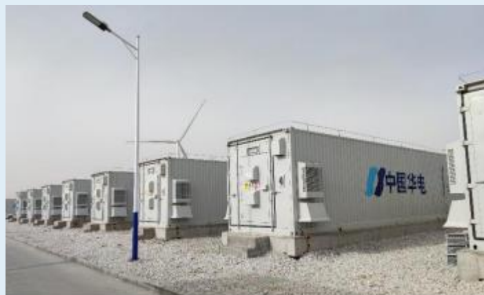
内蒙古某90MWh储能电站
