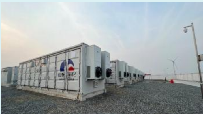
山东某120MWh储能电站
