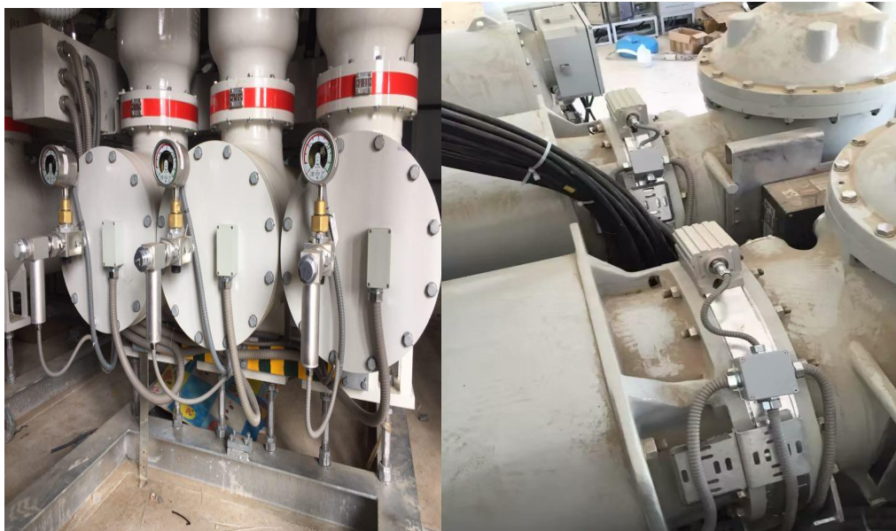
内置式及外置式局放传感器现场安装
